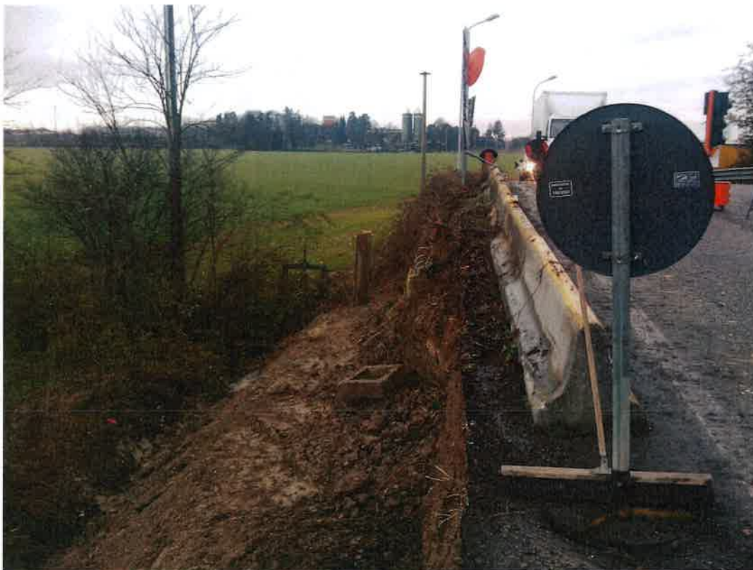
Allegato 2: fronte franato della riva.
