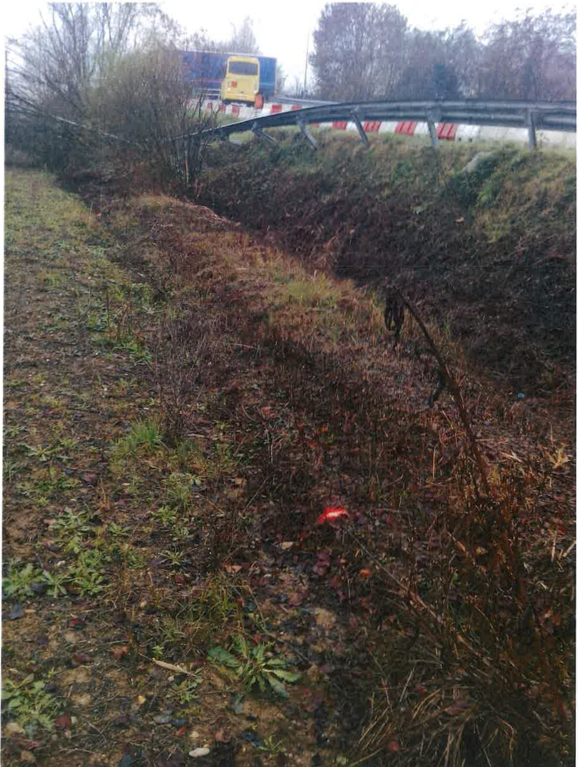
Allegato 1: dissesto della scarpata stradale, ribaltamento del guardrail e dei pali dell'illuminazione pubblica.
