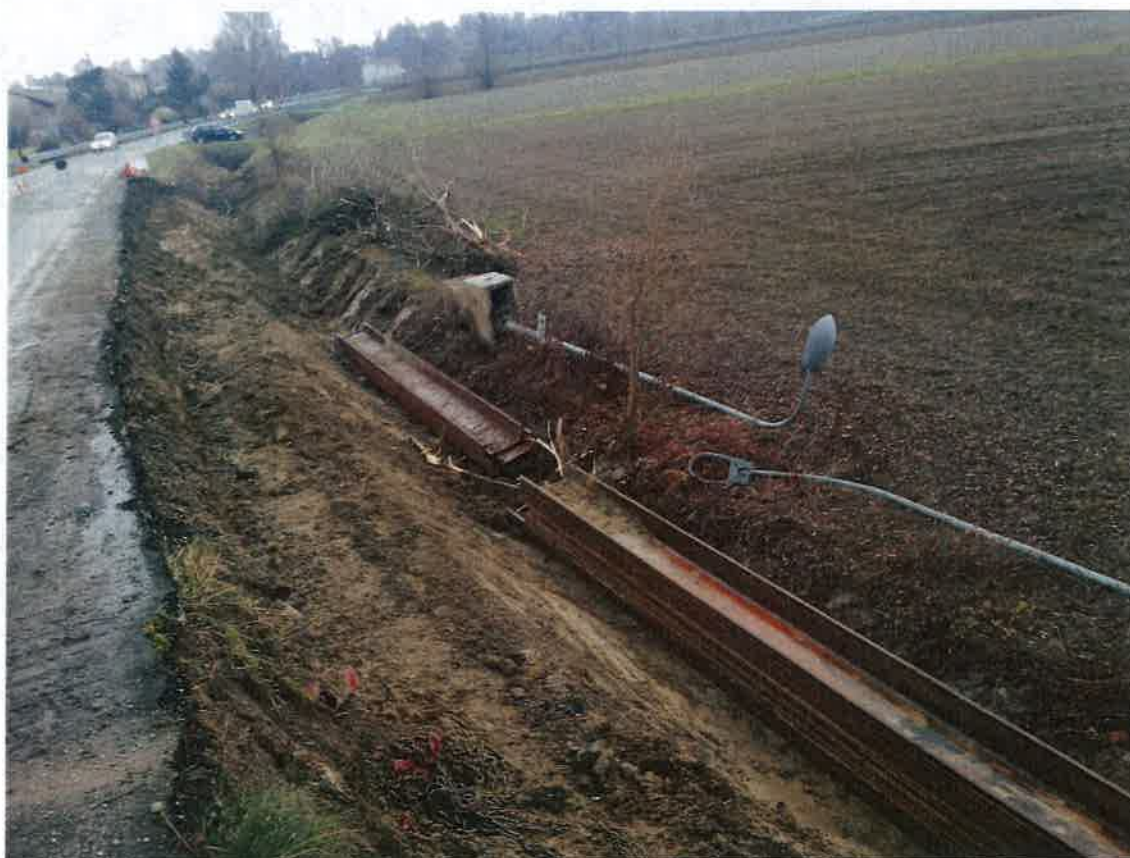
Allegato 3: fronte riva franato e pali dell'illuminazione recuperati in seguito a ribaltamento.
