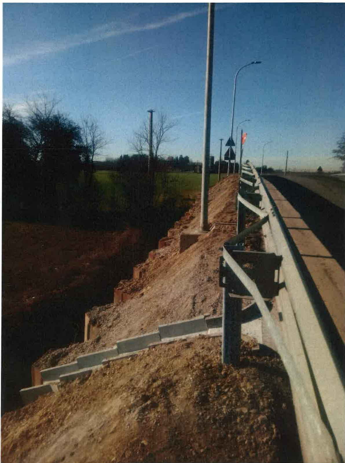
Allegato 7: vista ad ultimazione delle opere di ripristino della transitabilità lungo SP 126.
